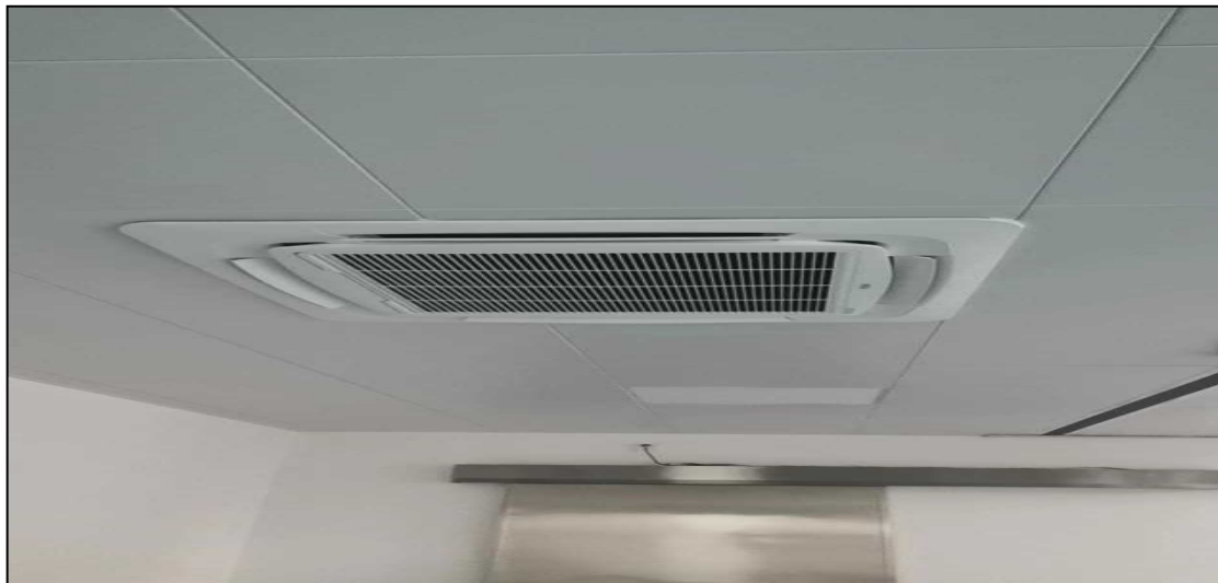
图 6-1 DSA 机房空调系统
